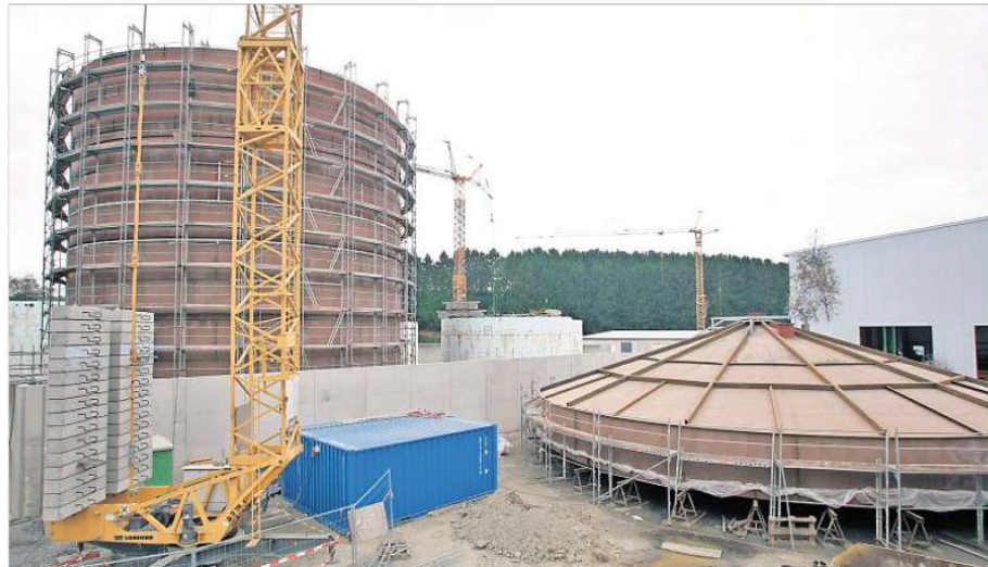
7000 Kubikmeter fasst der Fermenter (links) der groß dimensionierten Bioabfallvergärungsanlage. Die Biomüllannahme erfolgt in einer großen, geschlossenen Halle (rechts). Hier werden die angelieferten Bioabfälle auch gleich aufwendig sortiert: Störstoffe wie Blech, Plastik und Glas werden dabei von den biogenen Stoffen getrennt.
